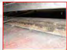
Suciedad difícil de limpiar
