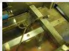
Cables Excedentes / Excesivo
