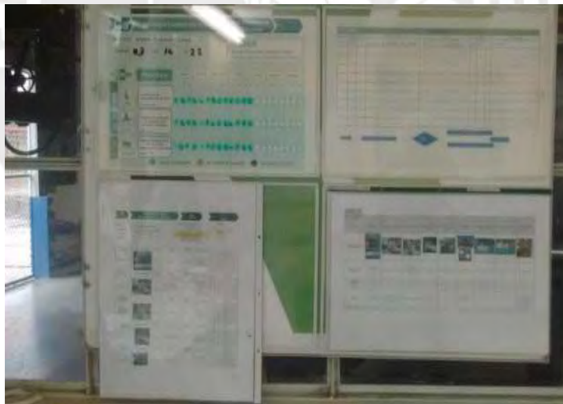
Figura 65 Tablero de cambio de turno en servicios industriales – sala de calderos. Fuente: De empresa en estudio
