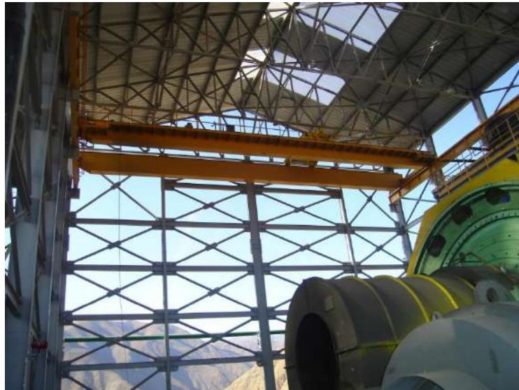
Figura 3: Puente grúa de 25tns-Nave industrial de molienda-Unidad Minera Cerro Lindo-Compañía Minera Milpo.
