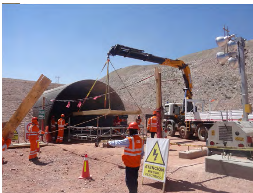
Figura 2. 10 Caso de innovación para traslado del marco estructural de las mesas dentro del túnel CV-201
