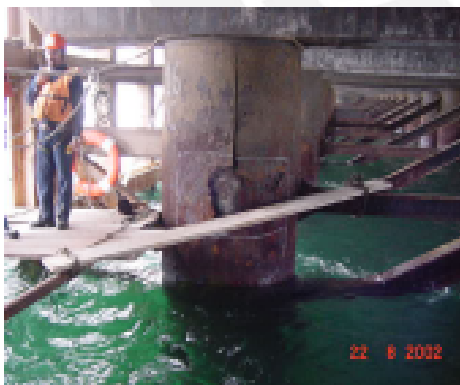
Foto 5.- Muestra una vista del daño provocado en la zona de “splash” en cada uno de los pilotes.
