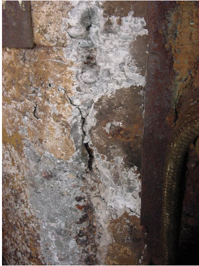
Foto 3.- Esta es otra vista de la fisura presentada en la figura 2. Nótese que la fisura nace paralela al refuerzo, lo que evidenciaría un daño por corrosión.
