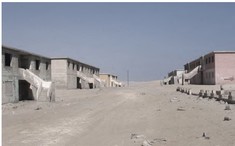
Fotografía San Juan de Marcona I. Vivienda para obreros en San Juan de Marcona. Vía: https://www.arcgis.com/apps/MapJournal/index.html?appid=6f33b0edcdef42f59a404e5825157e77
