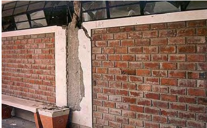
Figura 4: Falla en columna corta durante sismo de Nazca en 1996 (Fuente: DAI-PUCP, 2007)
