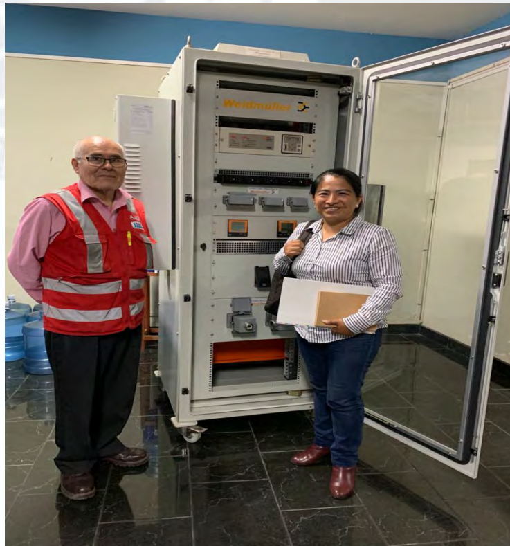
Figura E2. Exhibición de tablero de distribución.
