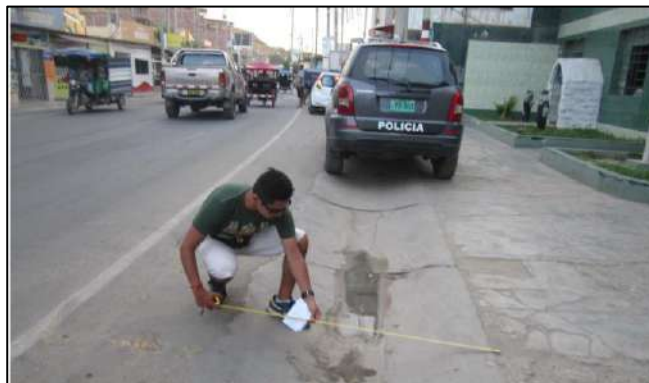
Figura 37: Toma de dimensiones de cunetas en centro urbano de Máncora. Fuente: Propia.
