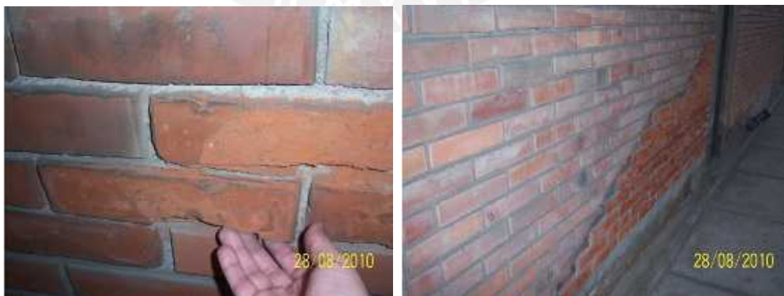
Imagen 5.3 Eflorescencia en el ladrillo en distintos puntos del cerco perimétrico del campus.
