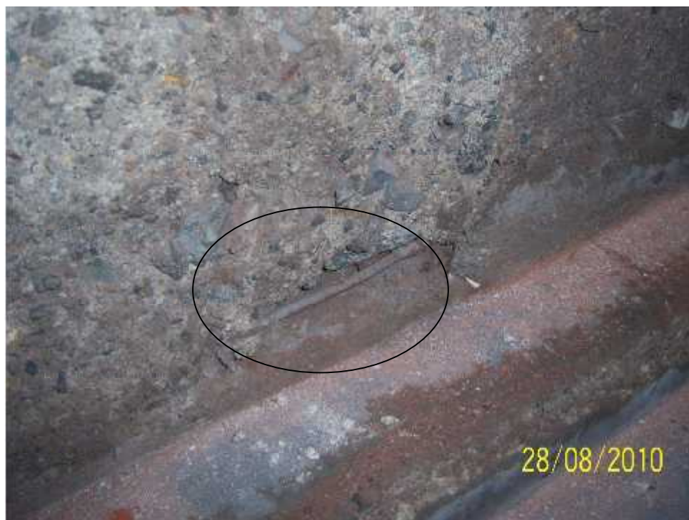
Imagen 6.2 Concreto expuesto, pérdida de recubrimiento y corrosión en el acero.
