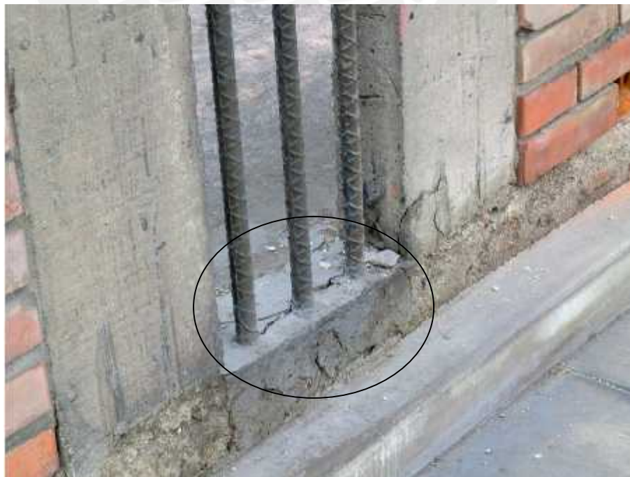
Imagen 5.1 Corrosión del acero en cerco perimétrico PUCP por carbonatación.
