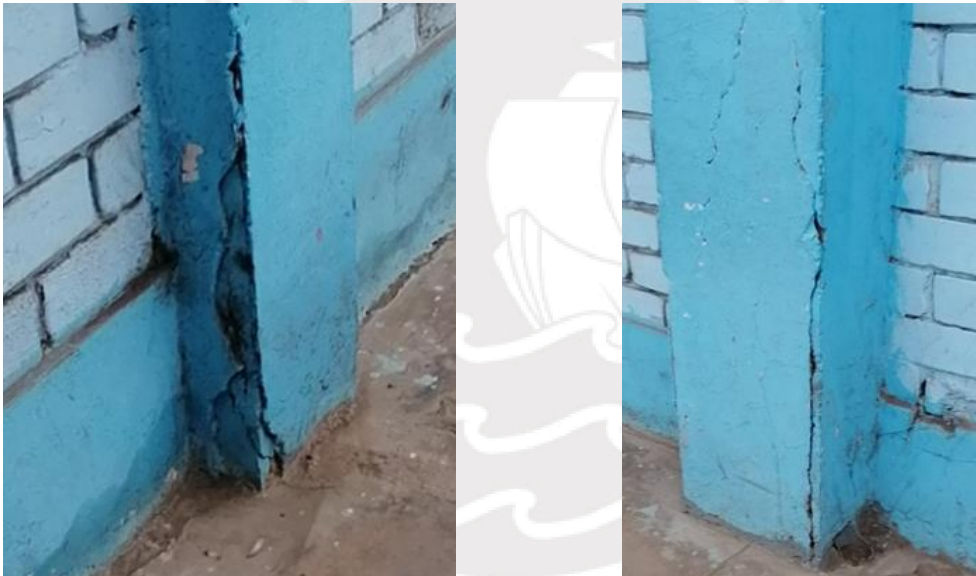
Imagen 3.5 Fisuras presentes en la base de las columnas ubicadas en el eje E
