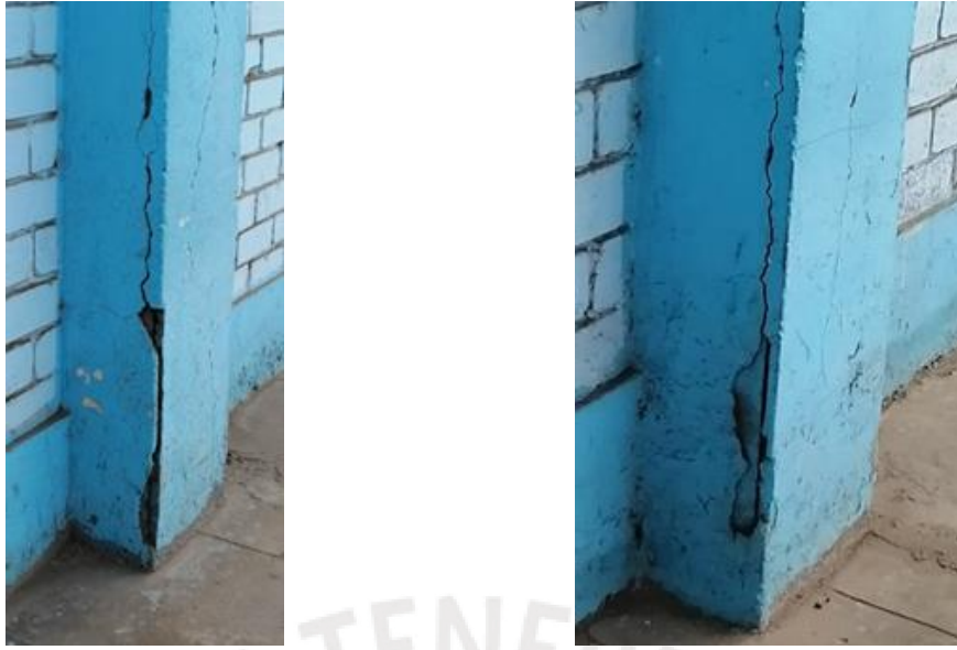
Imagen 3.4 Fisuras presentes en la base de las columnas ubicadas en el eje A.
