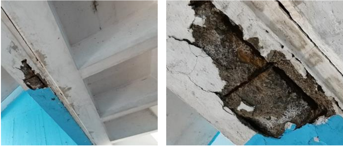
Imagen 3.8 Viga del eje 3 con acero corroído debido a un bajo recubrimiento
