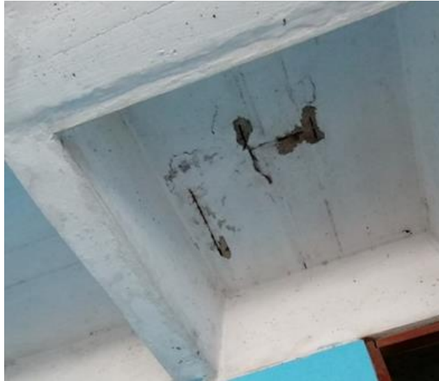
Imagen 3.10 Acero corroído y expuesto en losa nervada del voladizo
