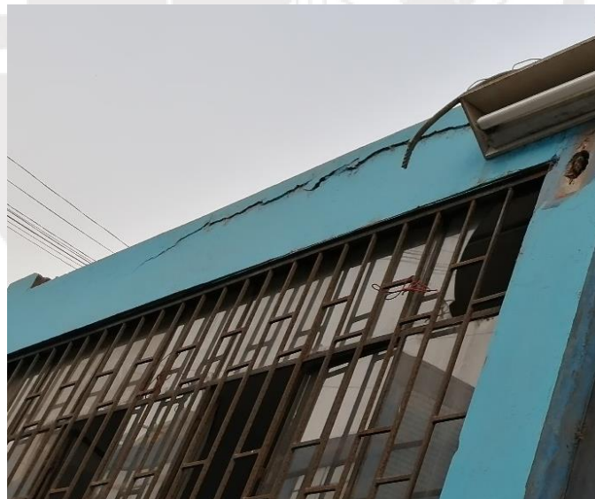
Imagen 3.7 Viga del eje A con fisuras longitudinales
