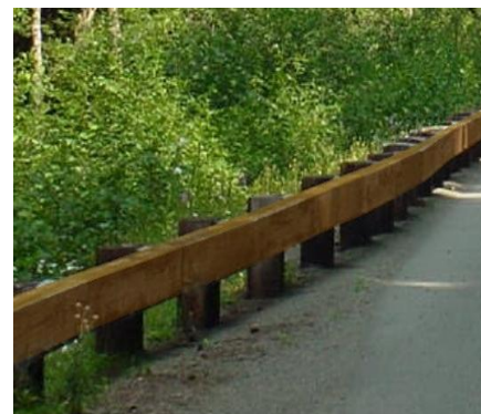
Fig. 3.14: Blacked Timber Guardrail Fuente: Washington State
