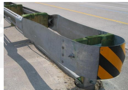
Fig. 3.35: Terminal CAT-350 Fuente: Powell Contracting Ltd.
