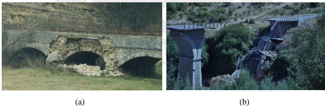
Figura 2.7. Tipos de daño en puentes de mampostería ante eventos sísmicos: (a) falla local: colapso del muro de spandrel de un puente de mampostería en arco (Resemini y Lagomarsino, 2004) y, (b) falla Global: colapso del puente del río Claro, terremoto de Maule, Chile, 2010 (Grossi et al., 2011, p. 34).
