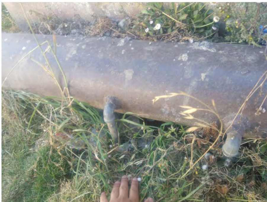
Fotografía 5: Conexión Clandestina - Distrito de Chaupimarca
