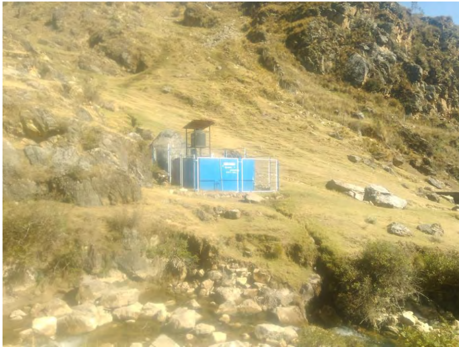
Fotografía 35: Tanque de agua - Distrito de Yanahuanca
