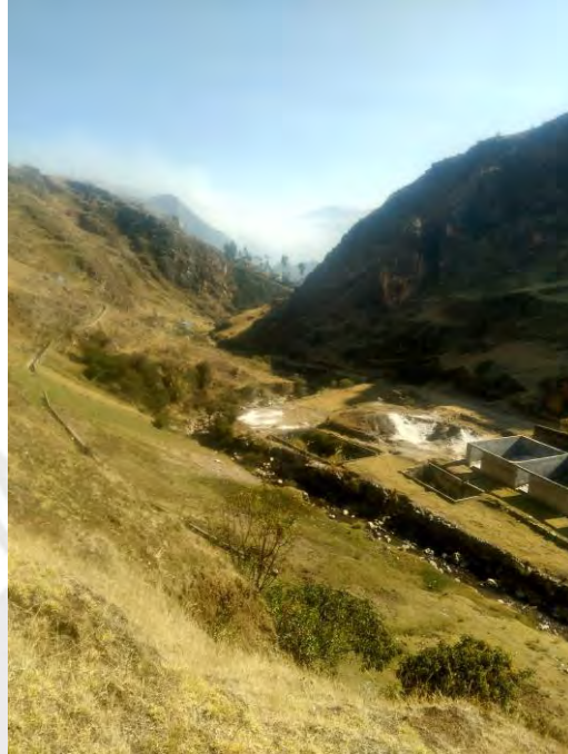
Fotografía 37: Rivera del río - Obra inconclusa de Planta de Tratamiento de Agua Potable - Distrito de Yanahuanca
