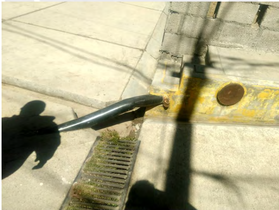
Fotografía 4: Conexión clandestina - Distrito de Chaupimarca
