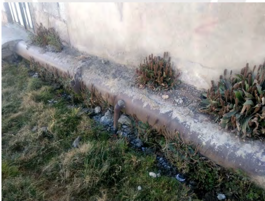
Fotografía 6: Conexión clandestina - Distrito de Chaupimarca
