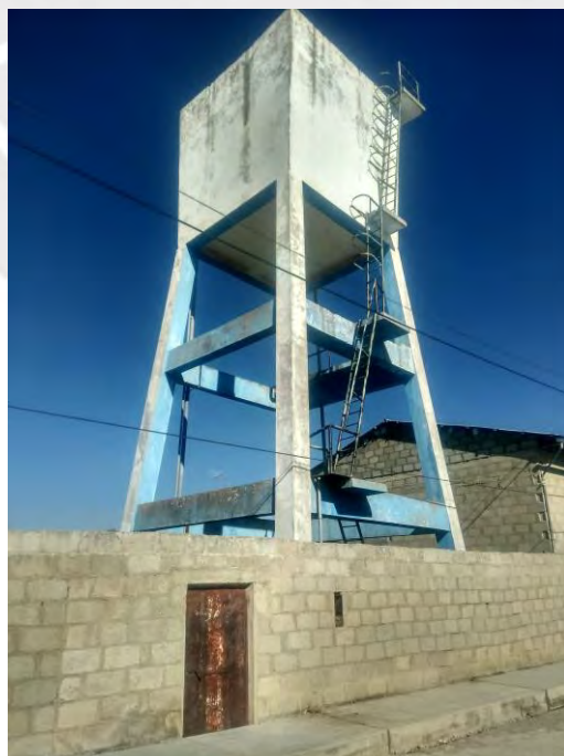
Fotografía 28: Tanque de agua – EMAPA PASCO - Distrito de Vicco
