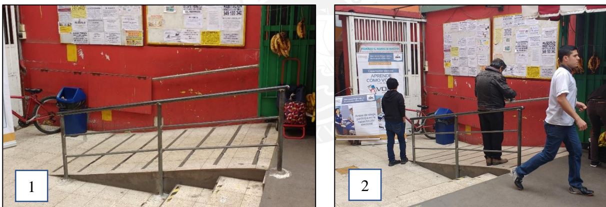
Figura 4. 15 – Problemas de diseño de rampa: 1). Pendiente elevada, 2). Presencia de peatones que se detienen a leer el periódico mural Elaboración Propia
