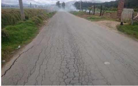
Ilustración 10. Estado inicial de la carpeta asfáltica
