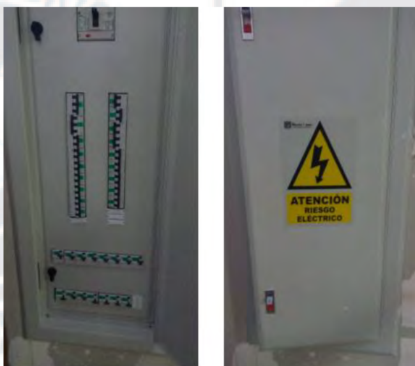
Figura 15. Tablero eléctrico de una agencia de COOPAC AQP. Adaptado de COOPAC AQP (2018). Informe de seguimiento de apertura de agencia Lima Sur.
