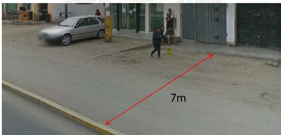
Figura 56 Estado actual de la acera peatonal
