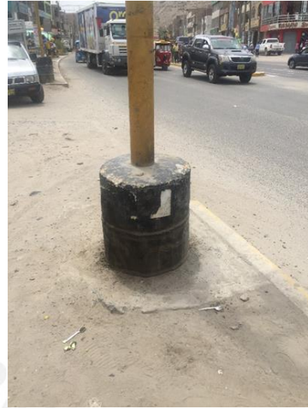
Foto 5 Soporte de semáforos
