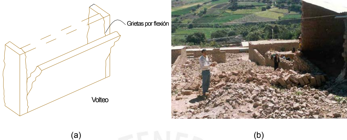
Figura 5.9 (a) Falla por volteo en un muro. (b) Colapso de muros por volteo.
