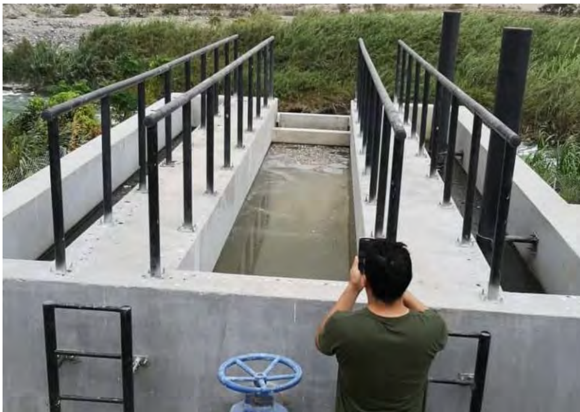
Figura 4.1. Presencia de aceites y grasas en la cámara de sedimentación del tanque Imhoff
