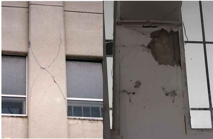
Figura 4.31 – Daño clase 3. A la izquierda, fisuras menores a 2mm. A la derecha se muestra el desprendimiento del recubrimiento
