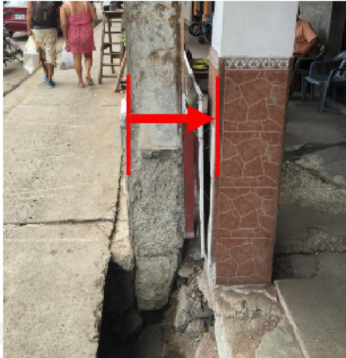
Figura 4.29 – Edificación fuera de su cimentación, desplazamiento lateral
