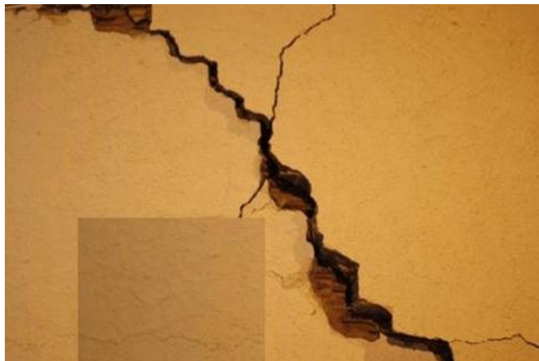
Figura 4.18 – Grietas en muros
