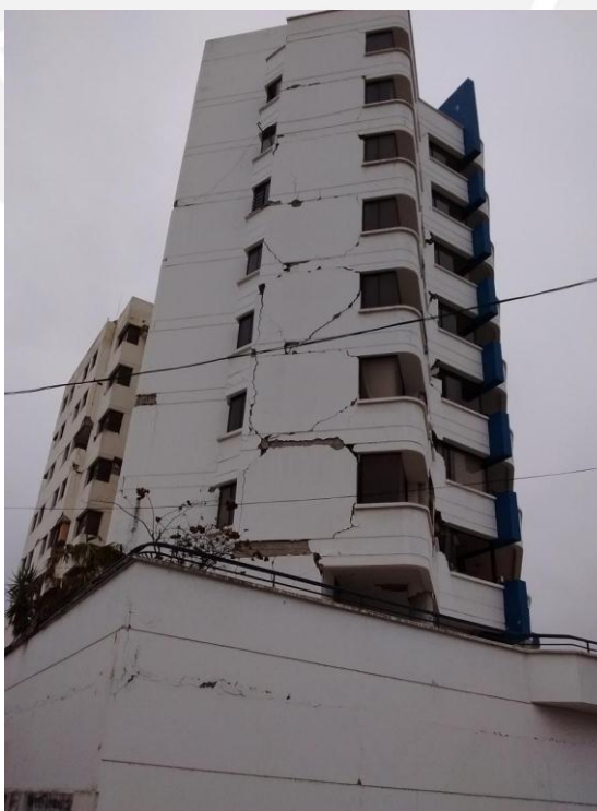
Figura 4.19 – Grietas en muros [8]
