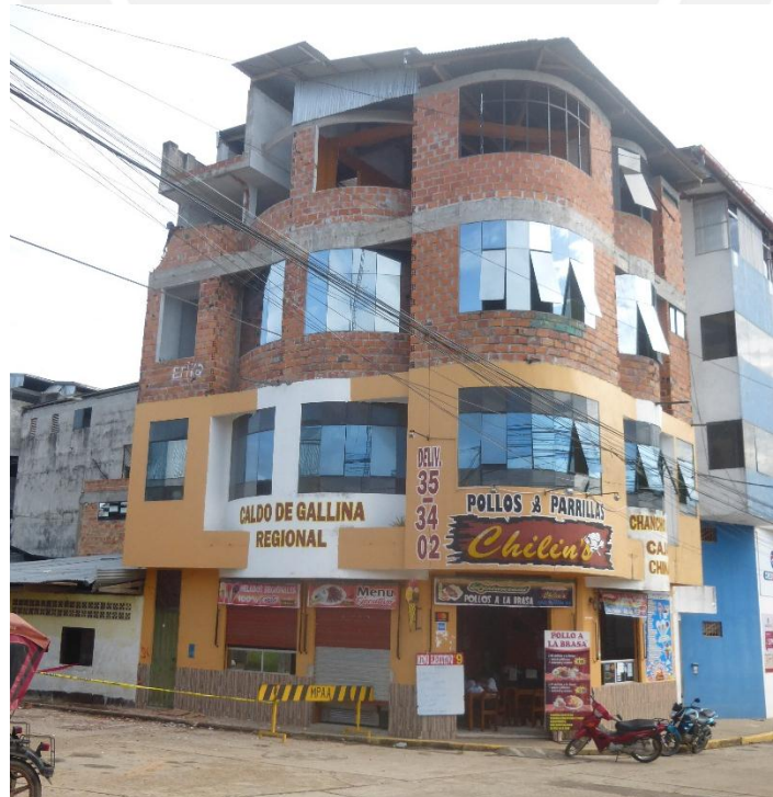
Daño en muros del tercer nivel, zona de escalera
