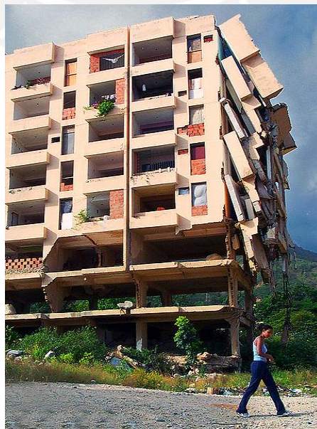
Figura 4.11 - Colapso parcial de elementos estructurales y no estructurales [55]
