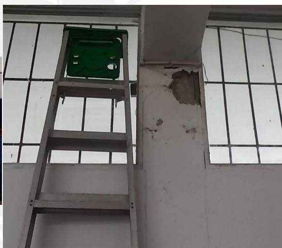
Daño tipo IV en columnas de concreto reforzado
