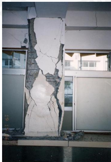
Figura 4.32 – Daño clase 4. Exposición de acero de refuerzo, desprendimiento de acero de refuerzo, grietas mayor a 2 mm.
