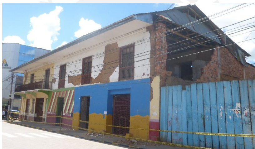
Daño en muros de adobe y albañilería
