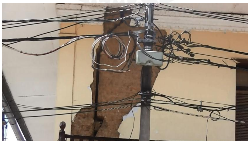
Inclinación del muro, grietas muy profundas
