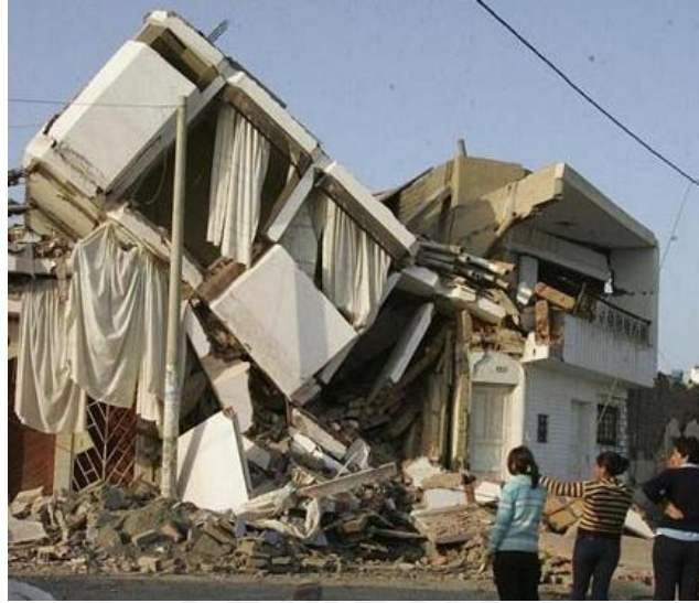
Figura 4.10 - En la edificación de la derecha no se tiene certeza del colapso parcial en la estructura [55]
