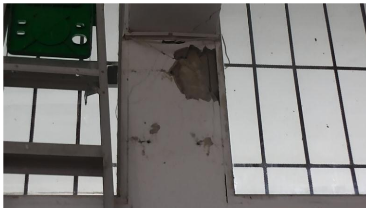
Figura 4.16 – Fisuras en columna y desprendimiento de recubrimiento
