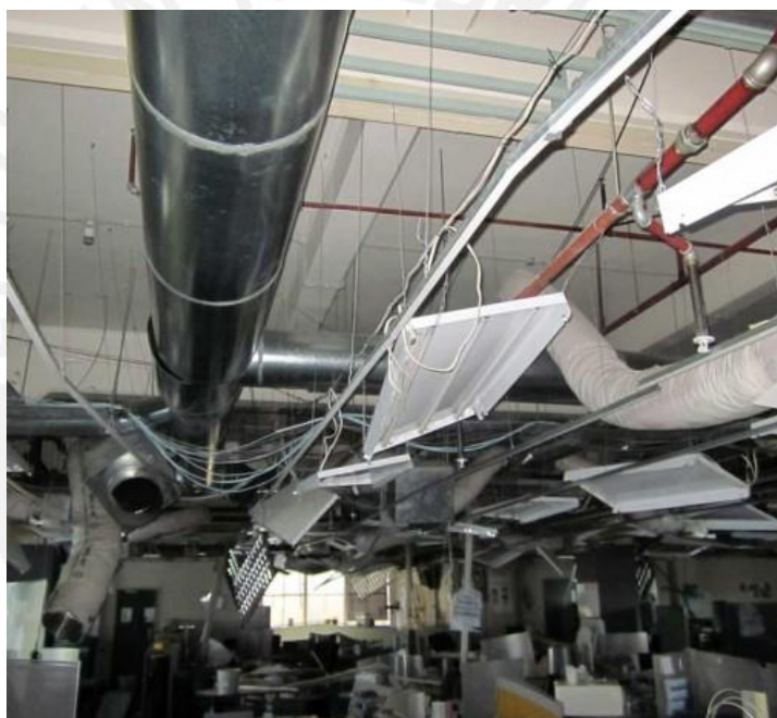
Figura 4.24 – Daños en instalaciones [6]
