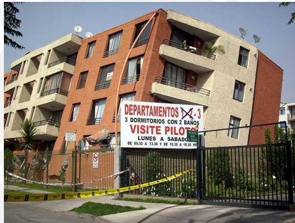
Figura 4.13 – Inclinación total de la edificación [56]
