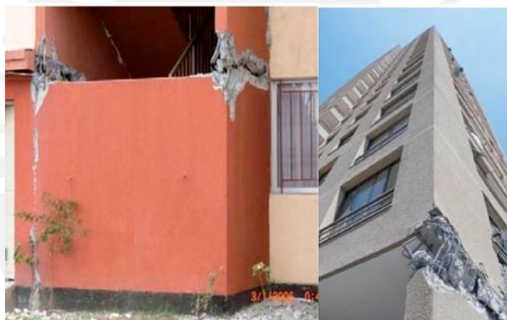
Figura 4.34 – Daño clase 5. Pandeo de acero de refuerzo en placas, desprendimiento del recubrimiento [23]
