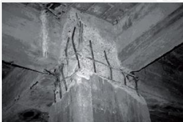
Figura 4.37 - Apariencia típica de daño severo en nudo
