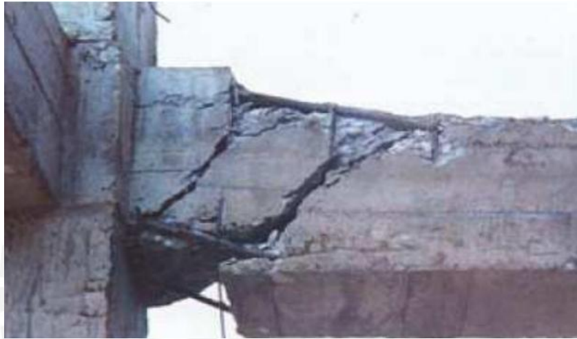
Figura 4.20 – Grietas en vigas
