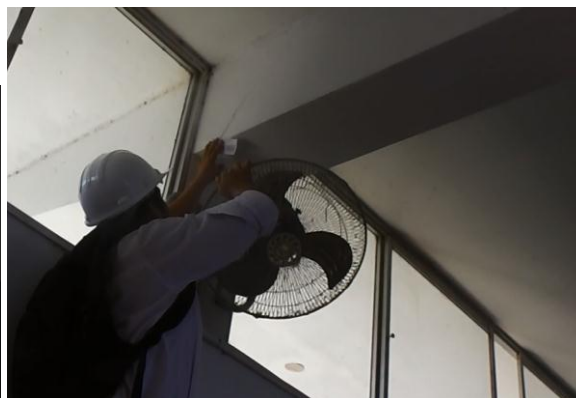
medición de ancho de fisura en vigas
