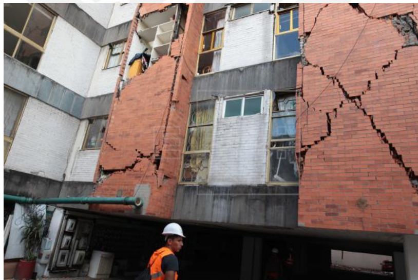
Figura 4.23 – Elementos no estructurales dañados [18]
