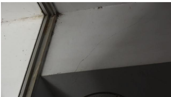
fisuras tipo corte, en vigas
