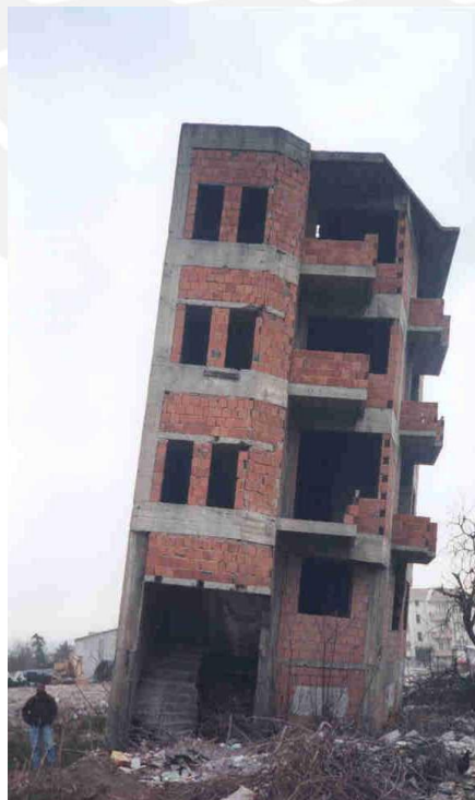
Figura 4.39 - Asentamiento diferencial e inclinación de la edificación
