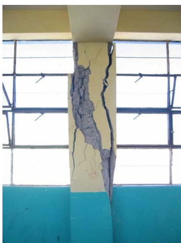
Figura 4.33 – Daño clase 5. Pandeo de acero de refuerzo de columnas, desprendimiento del recubrimiento [57]
