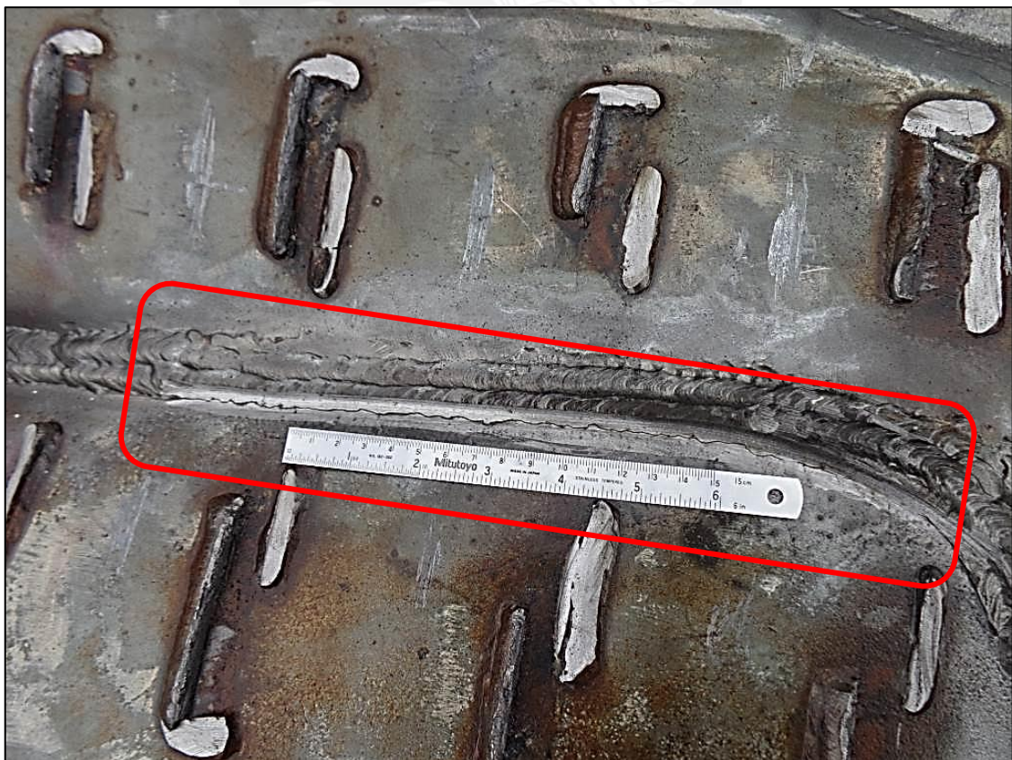
Figura 17. Fisura longitudinal ubicada en el pie del cordón, luego de esmerilar.
