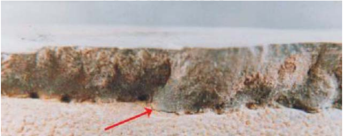
C) Fisura al pie del cordón
