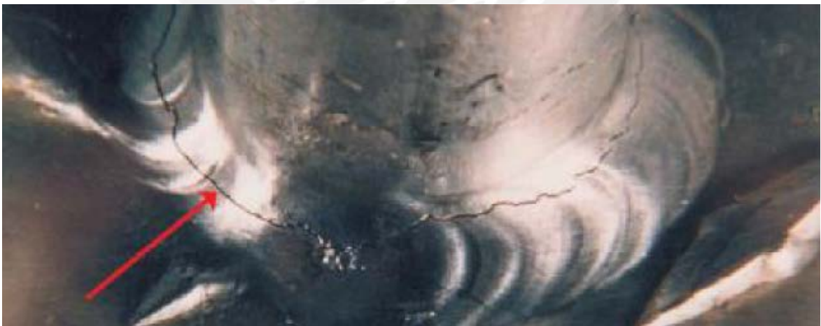
D) Fisura longitudinal al cordón de soldadura
