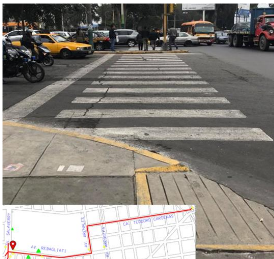
Figura 4.26 Rampas y cruces peatonales incompatibles. Fuente propia
