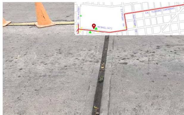
Figura 4.25 Juntas muy anchas sin relleno. Fuente: propia.
