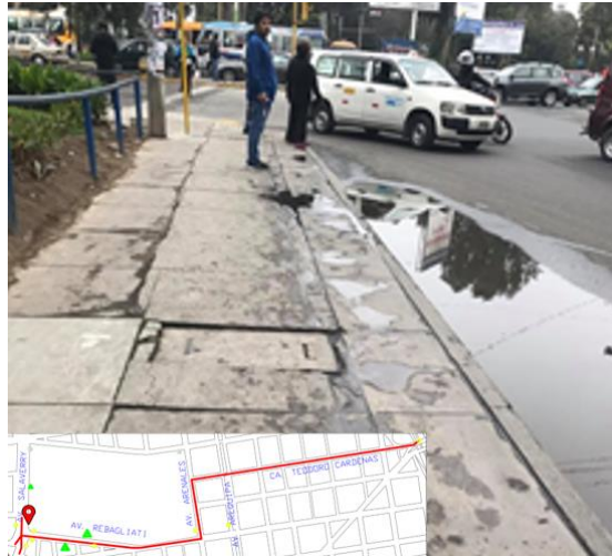
Figura 4.21 Concentración y empozamiento de agua. Fuente: Propia
