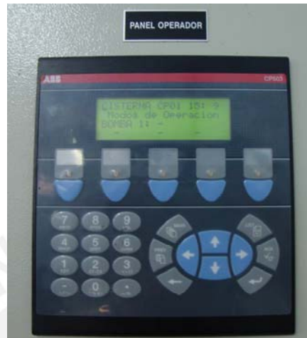
Figura 4.27. Panel de operador de la estación CP-01.
