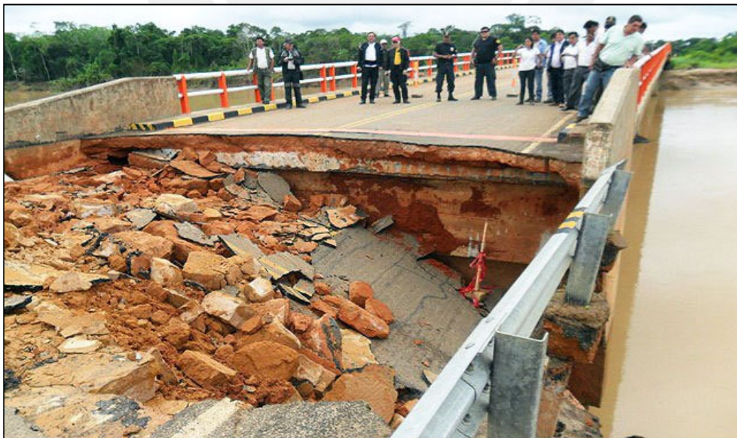
Foto N°10 Socavación producida detrás del estribo izquierdo del puente Tahuamanu, (Febrero 2012)
