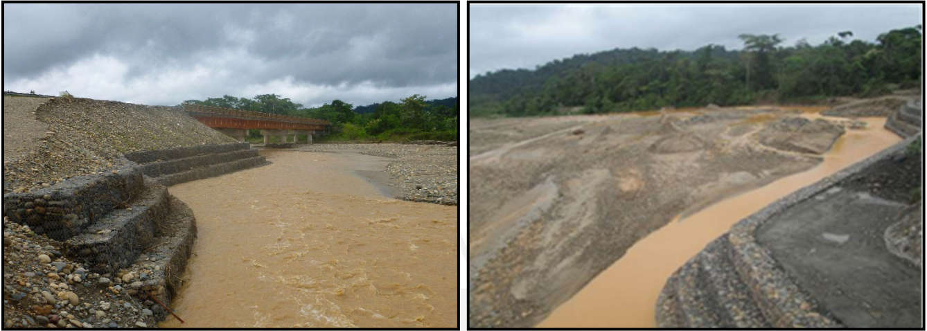
Foto N°11 y 12 Protección Ribereña con Sistema de Gaviones Margen Izquierda - Puente Dos de Mayo
