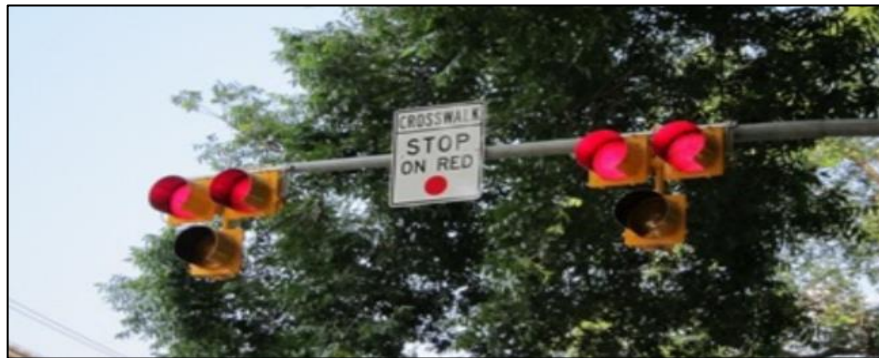
Figura 3: Faro híbrido peatonal
