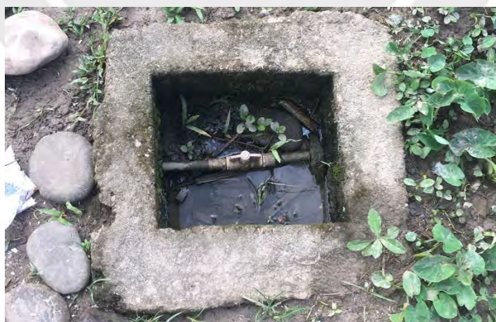
Foto 14: Válvula para controlar la salida del agua
