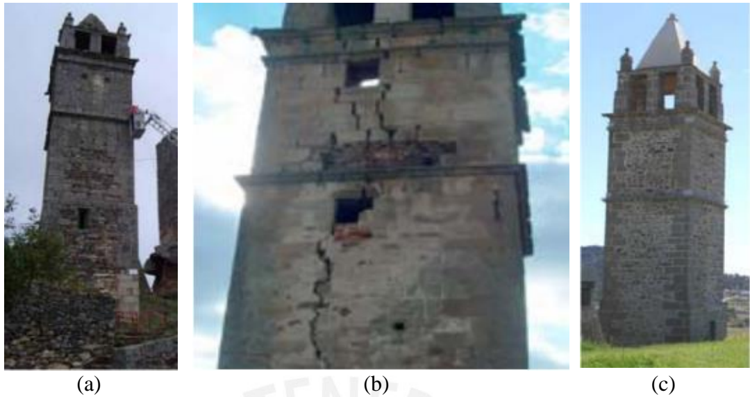
Figura 2.23: Torre de reloj de Mogadouro: (a) y (b) vista de la torre dañada antes de la intervención y (c) la torre después de los trabajos de reforzamiento (L F Ramos & Lourenço, 2007)
