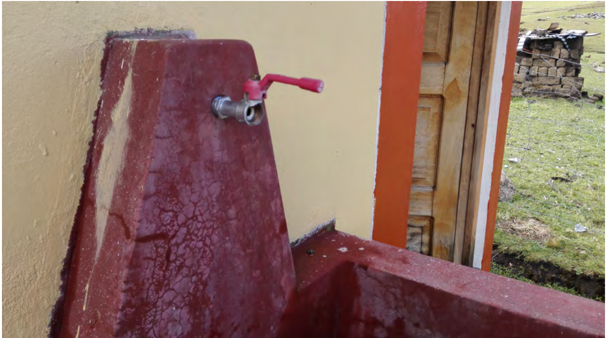
FUENTE: Pileta en estado deteriorado en la comunidad de Minascucho - vista fotográfica propia.
