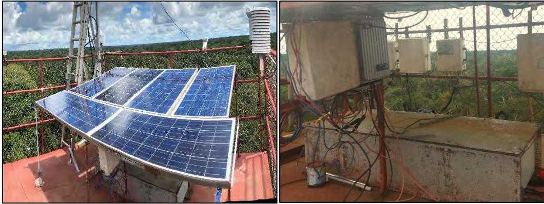
Figura 3.2. Elementos del suministro de energía: paneles solares (izquierda), controlador y baterías de gel (derecha).
