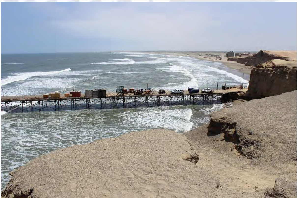
Figura A4. Muelle en Puerto Eten. Estructura que no presta condiciones de seguridad.
