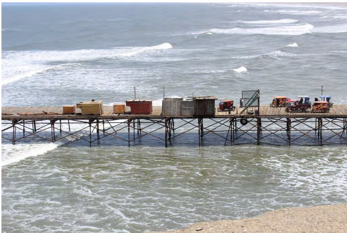
Figura 39. Estado precario del muelle artesanal de Puerto Eten.
