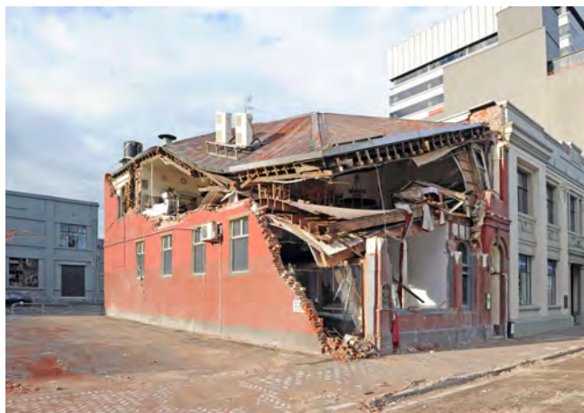
Figura 2.6: Falla fuera del plano en una estructura de albañilería
