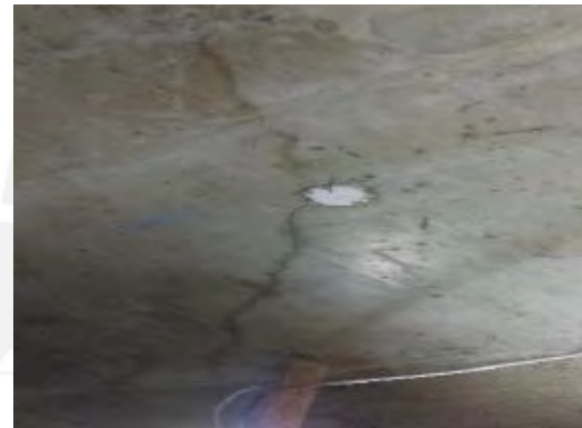
(b) Fisura en techo Sótano 3.
