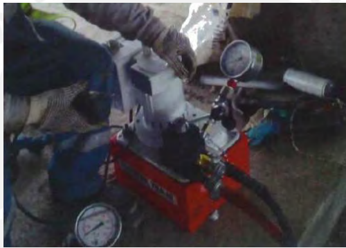
Figura 7. Bomba de inyección (Fuente propia).
