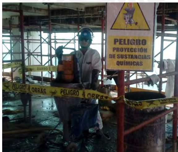
Figura 14. Equipo de inyección (Fuente propia).
