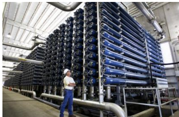
Figura 1. 8. Planta desalinizadora de ósmosis inversa 5
