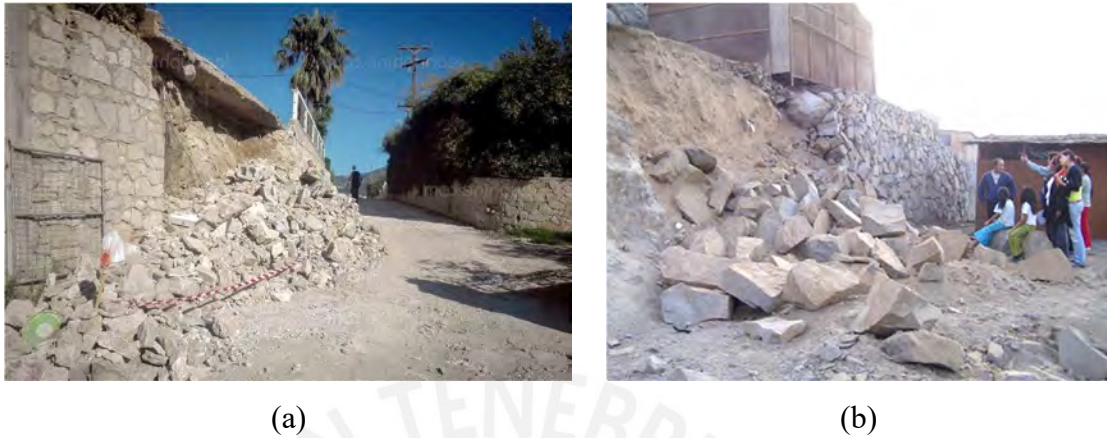
Figura 1.3: Colapso de muros de junta seca en (a) la isla de Zante, Grecia [16] y en (b) la periferia de Lima, Perú [17]
