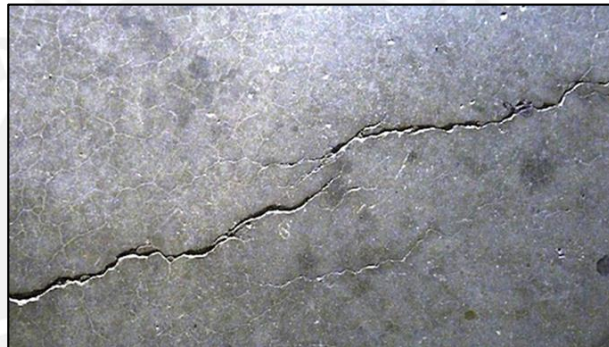
Imagen 12. Fisuras en concreto armado.
