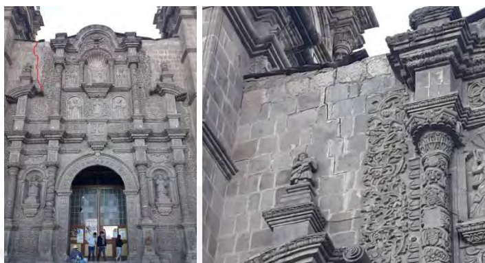
Figura 4.1. Estado actual de la fachada de la catedral de Puno
