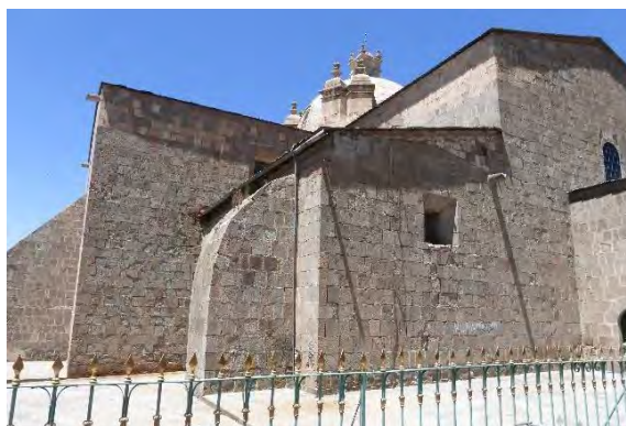
Figura 4.13. Irregularidad en altura en la catedral de Puno
