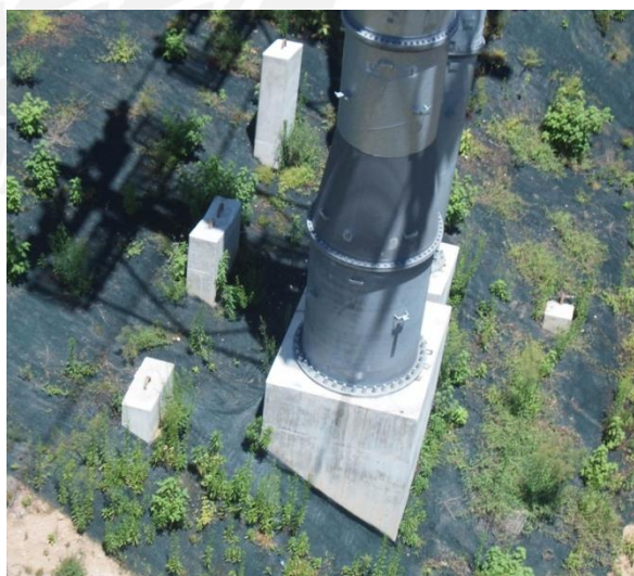
Figura 3.12 Detalle de pedestal de apoyo de una de las pilonas. Fuente propia
