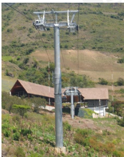
Figura 3.11 Pilona del sistema. Fuente propia
