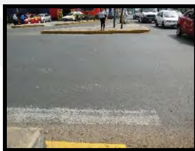
Figura 3.16 Cruces peatonales en mal estado
