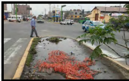
Figura 3.34 Peatones usan la calzada para transitar por el mal estado de la isla refugio ubicada en la Av. Metropolitana
