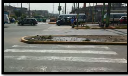
Figura 3.33 Mal estado de la isla refugio en la Av. Metropolitana
