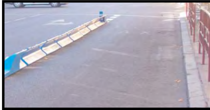
Figura 2.17 Separador de carril
