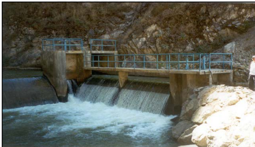
Figura 1.3 Mini central Hidroeléctrica Santa Leonor, Picoy – Huaura. Lima
