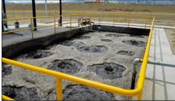
Figura 2.4.1-2. Lodos activados (Fibras y normas de Colombia S.A.S, 2015)
