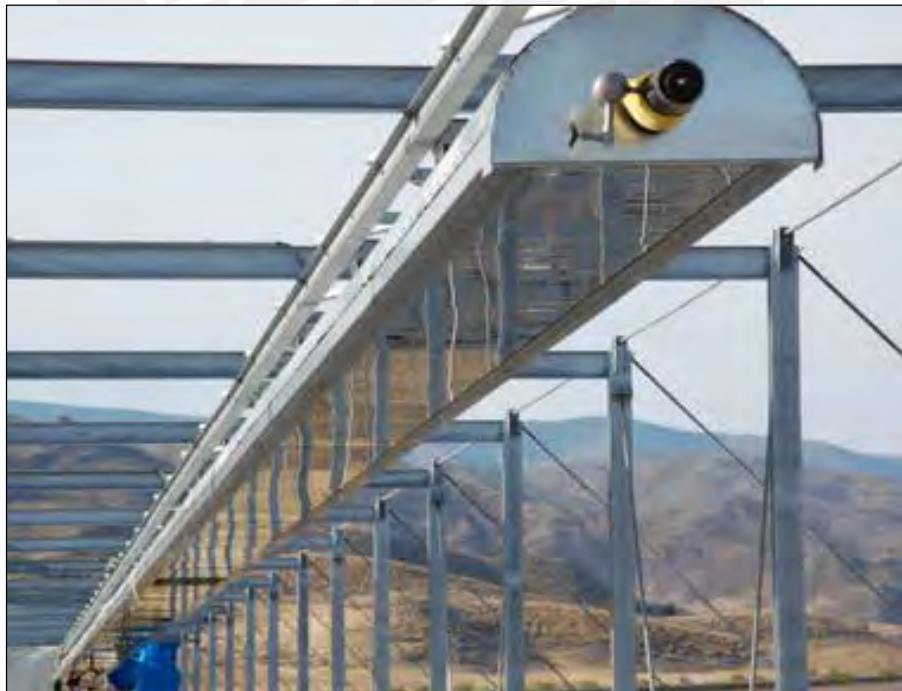
Figura I.8 – Montaje de CPC de LFC – Planta FresDemo/Ferrostaal – Almería, España (Fuente: SPG Ferrostaal, 2012).
