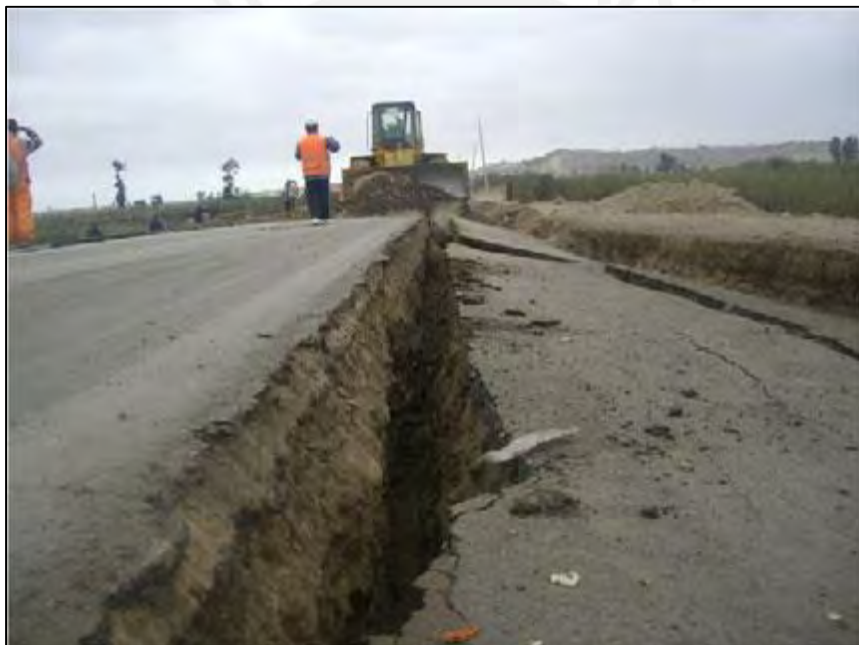
Figura 14. Impacto en la carretera Panamericana Sur
