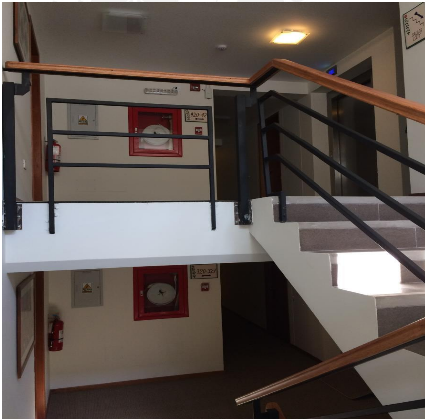
Figura 7.- Escaleras y sistema contra incendio Hotel San Agustín Plaza
