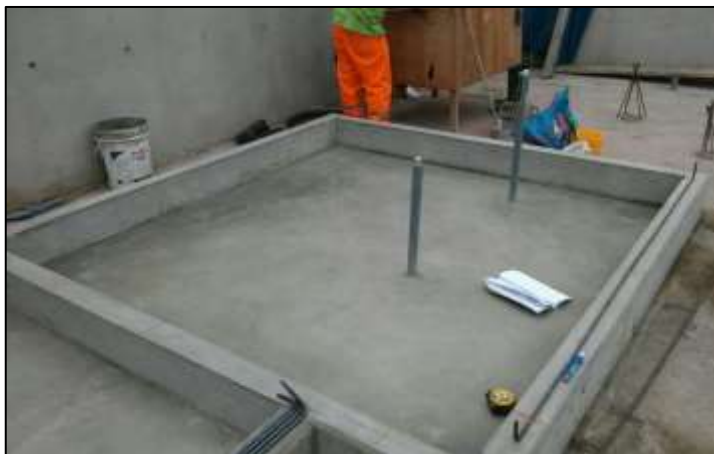
Fotografía 43: Vaciado de sardines para losa flotante del sistema de bombeo condensado primario y secundario (Cuarto de Servidores).
