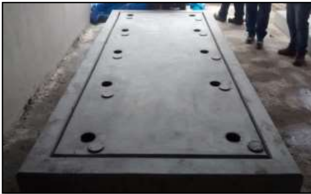
Fotografía 27: Una vez vaciada la losa de concreto sobre la losa estructural, se procederá a retirar la tapa del mouting y posteriormente el casting de compresión ubicado en su interior.
