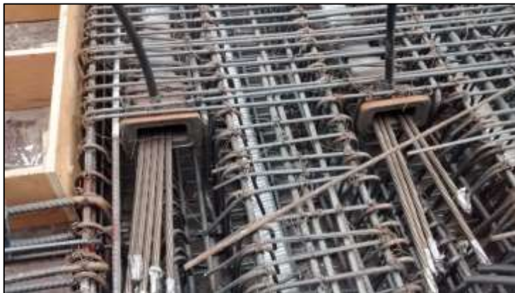
Fotografía 52: Se aprecian los anclajes colocados al finalizar la distribución de los ductos, los cuales contienen en su interior los tendones de acero aun sin tensar.
