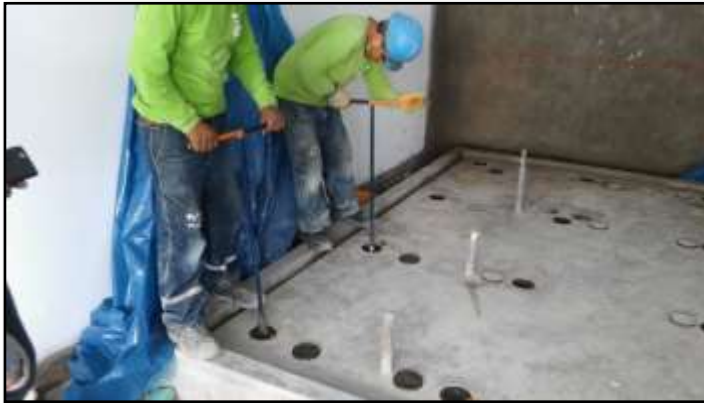
Fotografía 41: Ajuste de cover plates para proceder a la nivelación de la losa flotante del sistema de bombeo condensado.
