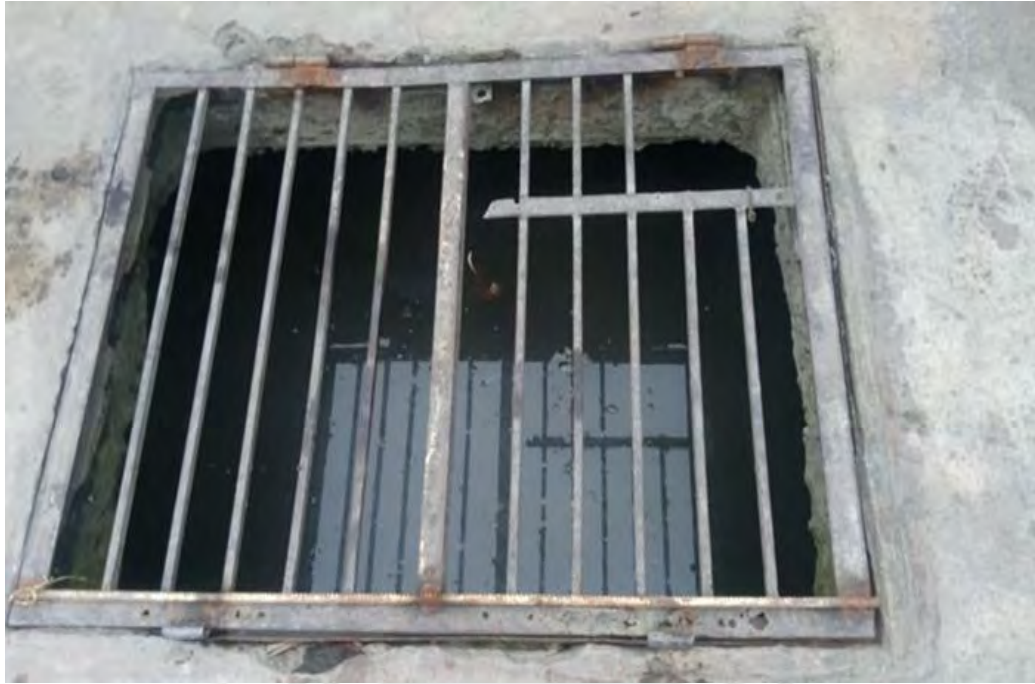
Figura 17. Tanque de sedimentación de la planta de tratamiento preliminar (Fecha: 01 de agosto de 2017, Fuente: propia)
