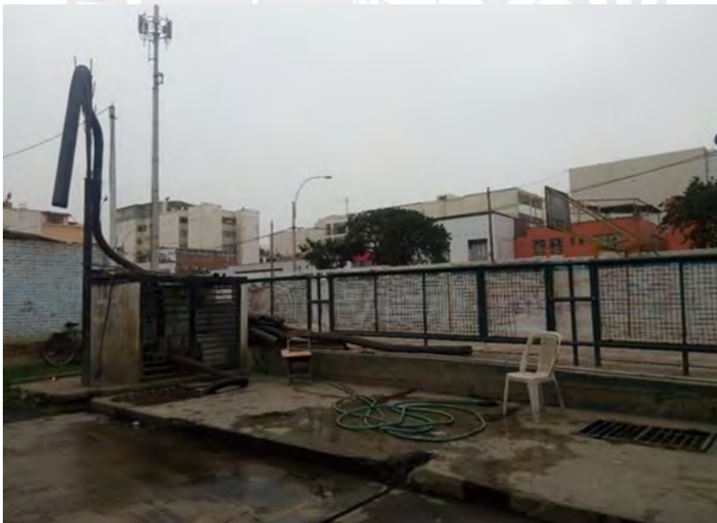
Figura 16. Planta de tratamiento preliminar del agua de regadío de áreas verdes del distrito de Pueblo Libre (Fecha: 01 de agosto de 2017, Fuente: propia)
