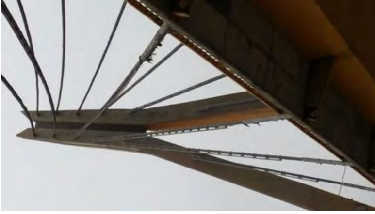
Foto 31 – Vista de los cables que nacen de la torre
