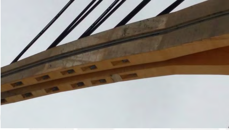
Foto 30 – Anclaje de cables en la torre
