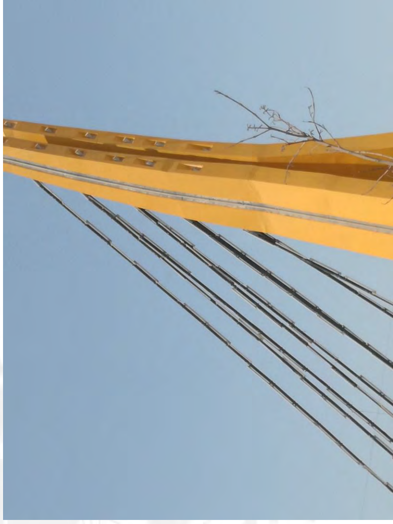
Foto 67 – Detalle del anclaje de los cables en la torre luego del desastre natural
