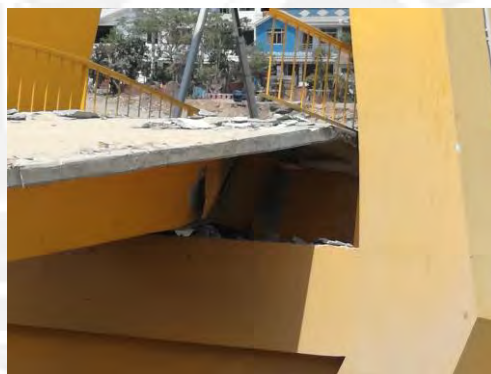
Falla local en la unión de las vigas de concreto y acero – Figura 5.2
