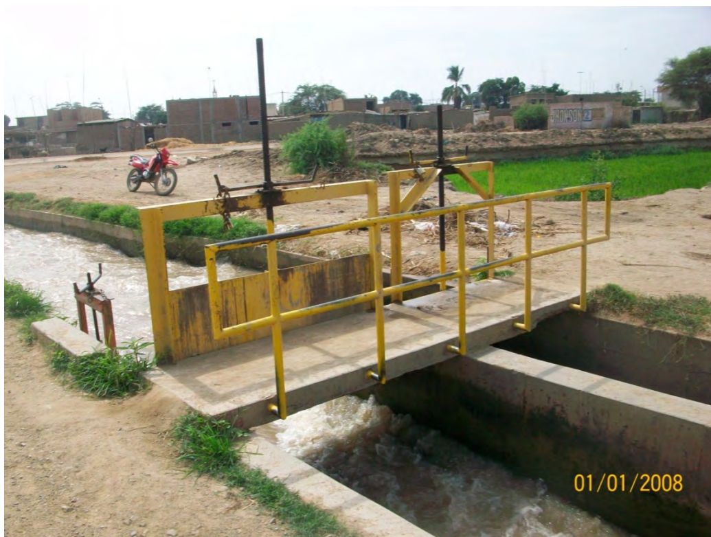
Compuertas de una sección del canal secundario Limón
