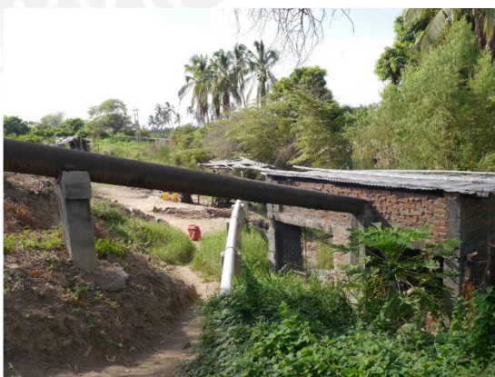
11. Estaciones de bomba de agua - Bloque Querecotillo (20/02/2016)
