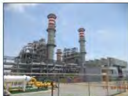
Calderas Recuperadoras de Calor y Chimeneas Principales (Unidades 1 y 2)
