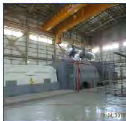
Unidad de Generación (Turbina a vapor)
