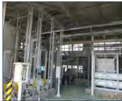
Vista de la Planta de Tratamiento de Agua.
